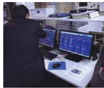
ビルエネルギーマネジメントシステム
